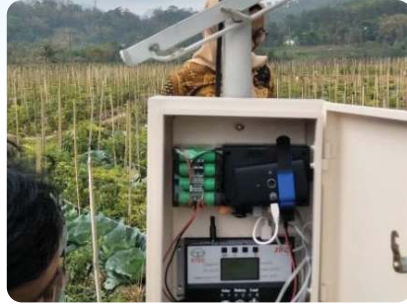
Gambar 2.6 Pemasangan Sensor Tanah dan Cuaca
