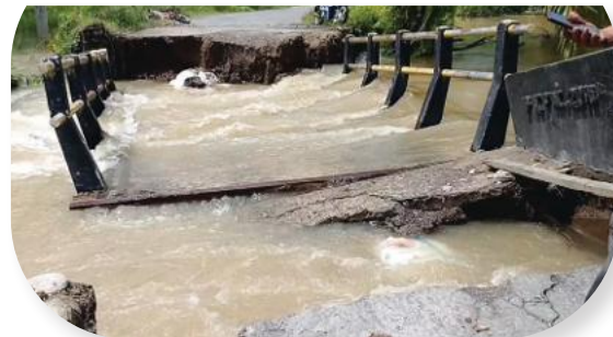
Gambar 2.6 Jembatan Rusak Akibat Banjir
