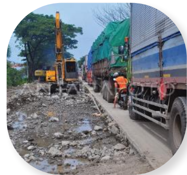
Gambar 3.4 Jalan Rusak Kategori Struktural
