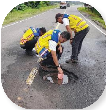
Gambar 3.3 Pengecekan Kerusakan Jalan
