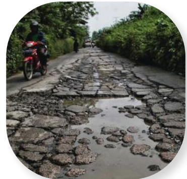
Gambar 2.1 Konstruksi Jalan Rusak
