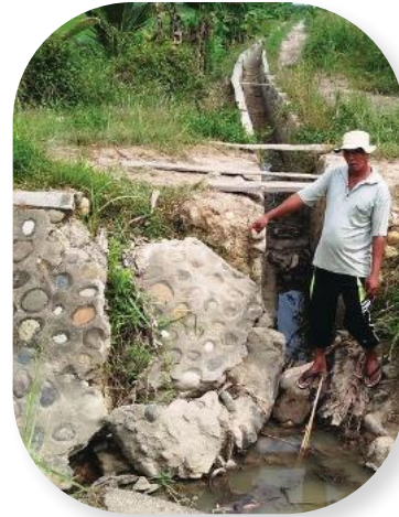
Gambar 2.4 Saluran Irigasi Rusak di Aceh
