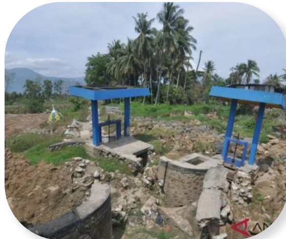
Gambar 4.4 Kerusakan Sarana dan Prasarana Pertanian di Sulteng
