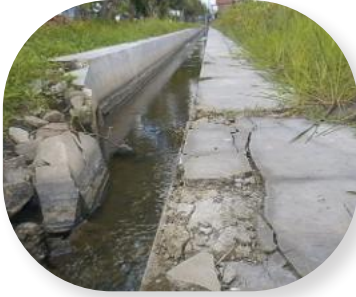
Gambar 4.5 Saluran Irigasi Rusak di Jombang
