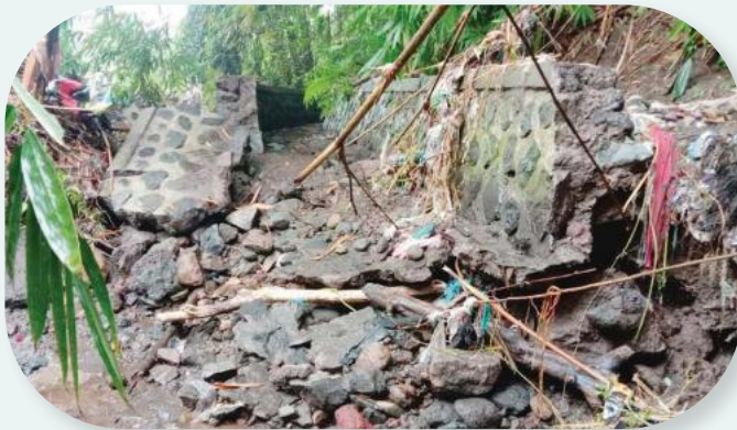
Gambar 2.8 Kerusakan Saluran Irigasi
