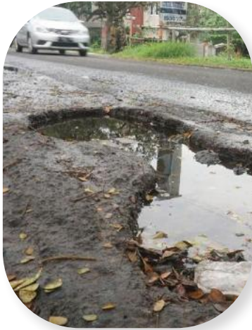
Gambar 2.2 Konstruksi Jalan Rusak
