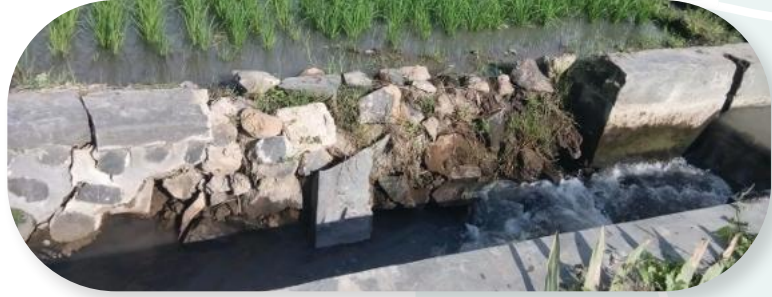
Gambar 4.6 Kerusakan Saluran Irigasi di Tamanagung
