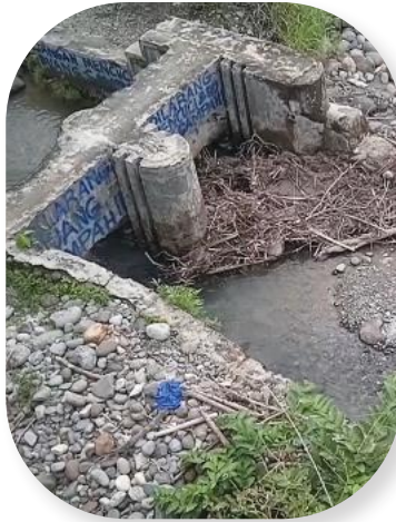
Gambar 2.3 Saluran Irigasi Rusak di Sumatera Barat
