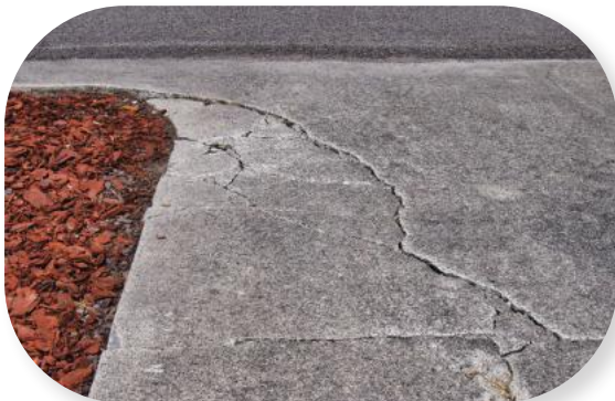
Gambar 2.5 Jalan Penghubung sebelum Masuk ke Jembatan Mengalami Retak
