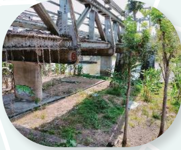
Gambar 5.2 Contoh Kerusakan Perkuatan Struktur pada Jembatan Bantar I
