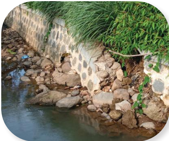
Gambar 4.3 Proyek Saluran Irigasi di Majalengka Rusak
