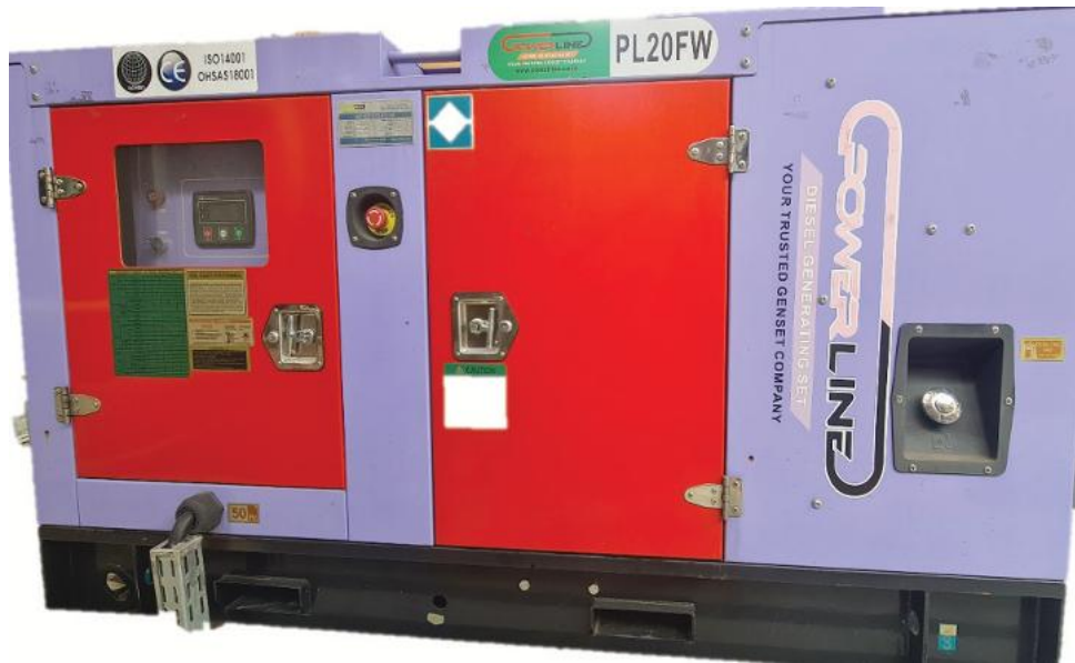
Gambar 4.6 Pembangkit Listrik Tenaga Diesel Sumber: Zainul/Kemendikdasmen (2024)
