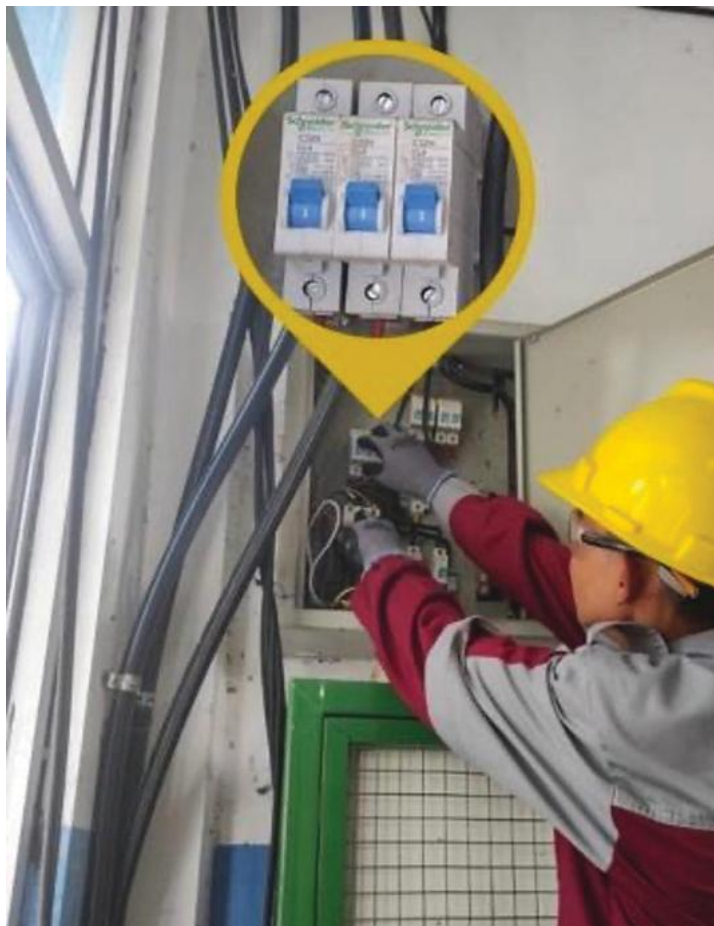
Gambar 1.11 Menyalakan MCB di Panel Distribusi Sumber: Feviana/Kemendikdasmen (2025)
